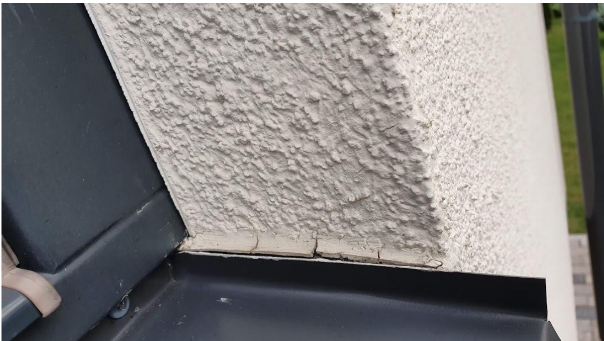
Valesti paigaldatud ja vale mastiks.
